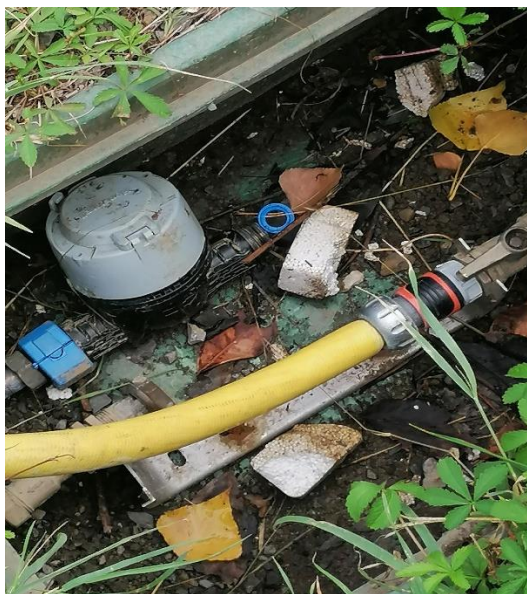
Branchement hydraulique pirate
